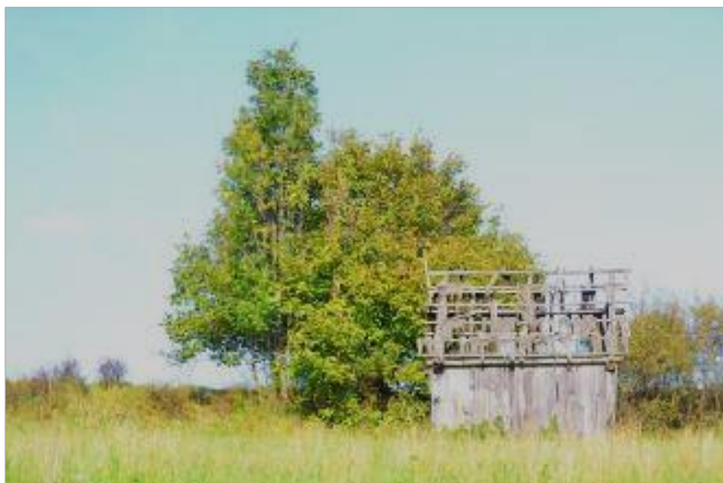
Obr. 17 Vlkolínec – senník v zlom technickom stave (FOTO: E. PAUDITŠOVÁ, 2018)
