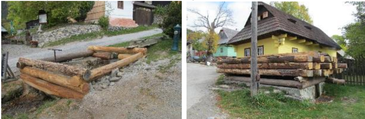
Obr. č. 5: Oprava a zvýšenie kapacity požiarnych nádrží (foto: P. Caban, jeseň 2021)
